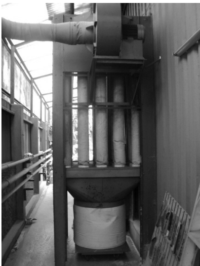
ระบบการจัดการฝุ่นบริเวณพื้นที่ปฏิบัติงาน
